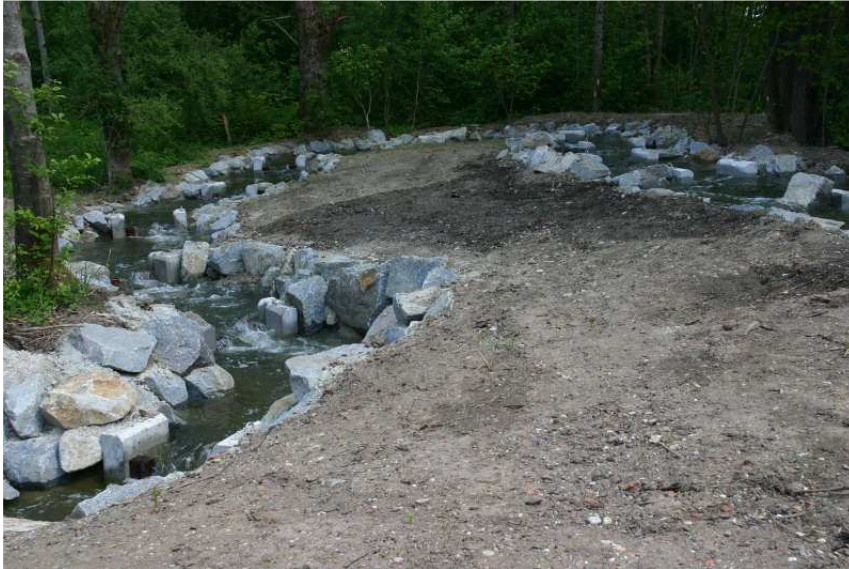
Abb. 9 Naturnaher Fischaufstieg mit Schlitzelementen in Betrieb
