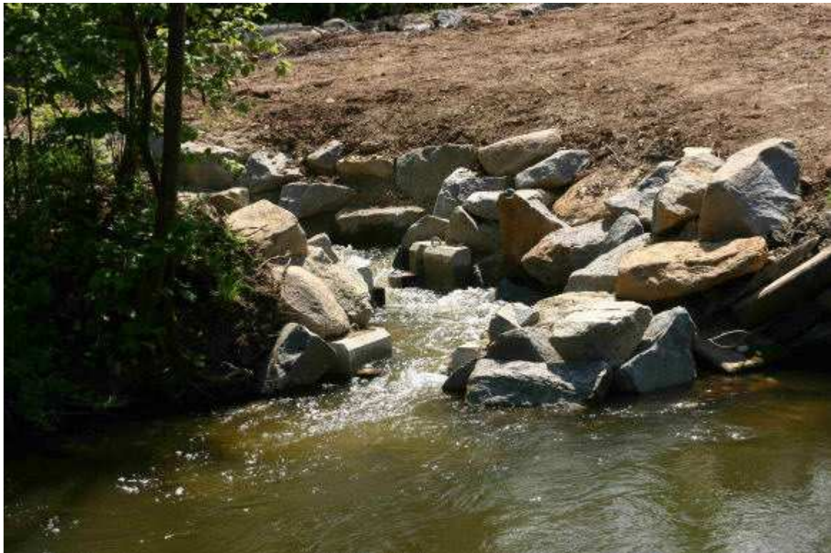
Abb.1: Fischaufstiegshilfe mit zwei Schlitzelementen am Auslauf in das Unterwasser
